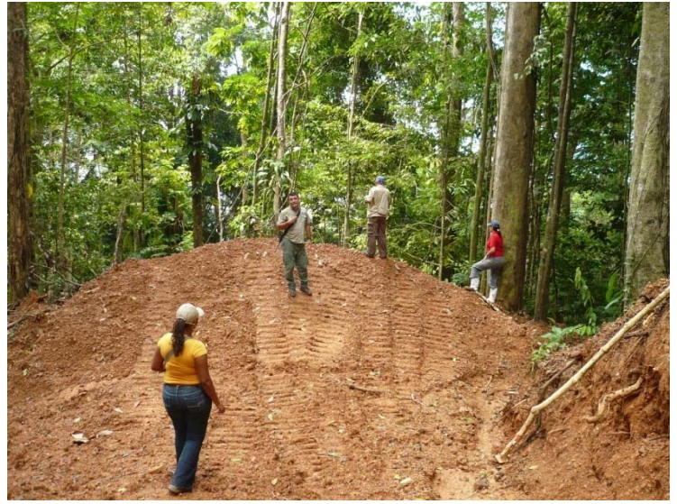
Grandes movimientos de tierra. Grandes cantidades de tierra fueron removidas y han caído bosque abajo arrasando vegetación y atemorizando a los vecinos de un pueblo aledaño.
